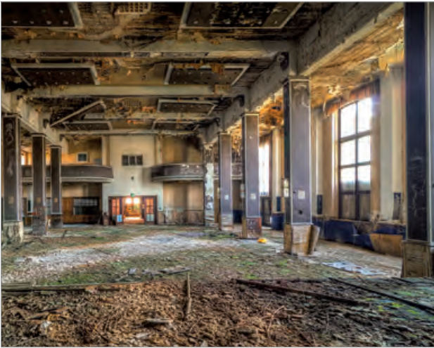
Der völlig marode Ballsaal des AWD-Klubhauses vor der Sanierung.
