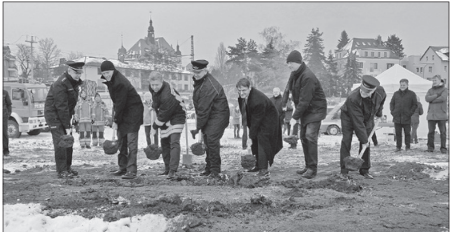
Erster Spatenstich mit v.l. Kreisbrandmeister Ingo Nestler, Wahlkreisabgeordneter Landtagspräsident Dr. Matthias Rößler, Oberbürgermeister Bert Wendsche, Ortswehrleiter Hans-Peter Schaefer, Techn. Beigeordneter Tilo Lindner, Baubürgermeister Dr. Jörg Müller und Stadtwehrleiter Roland Fährmann
