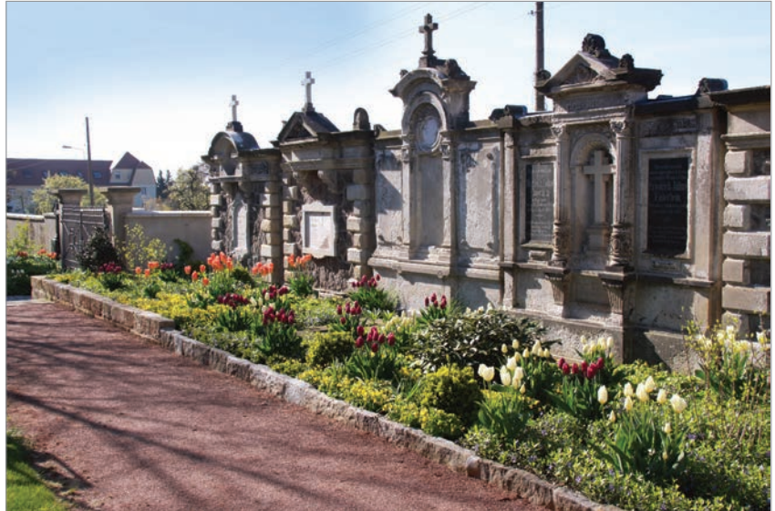
Im Jahr 2015 sanierte denkmalgeschützte Wandgrabstellen an der südlichen Friedhofsmauer des Hauptfriedhofs Radebeul-Kötzschenbroda
